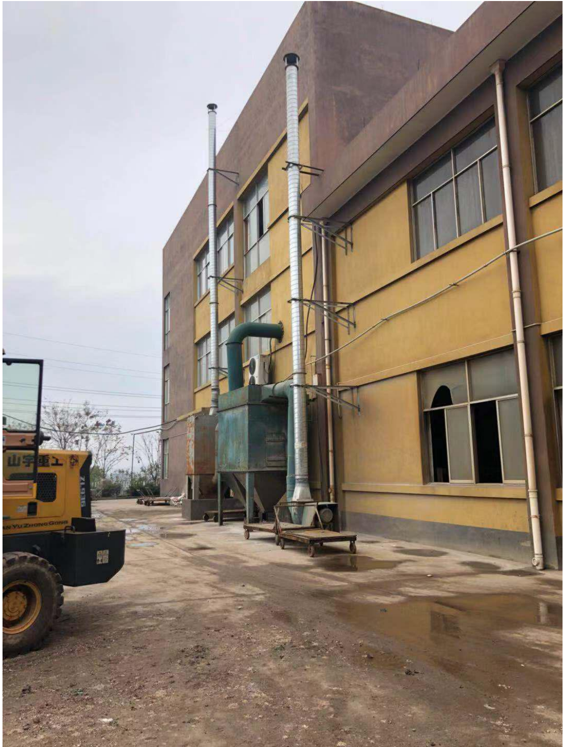
喷塑废气排气筒
