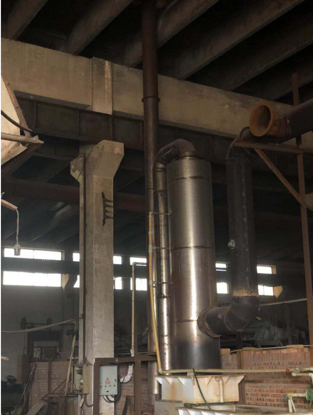
燃烧废气排气筒
